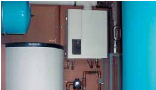
Heizung mit Gasbrennwerttherme
