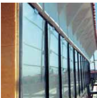
Kollektoranordnung in der Fassade erhöht die winterliche Solarausbeute
