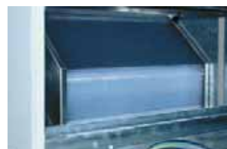
Wärmetauscher des Lüftungsgeräts
