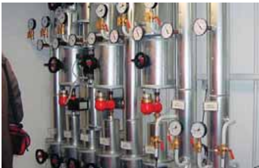
Leitungssystem hydraulisch optimieren
