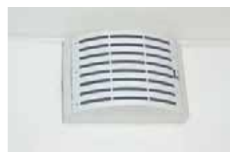
Abluftelement mit Filter in der Küche
