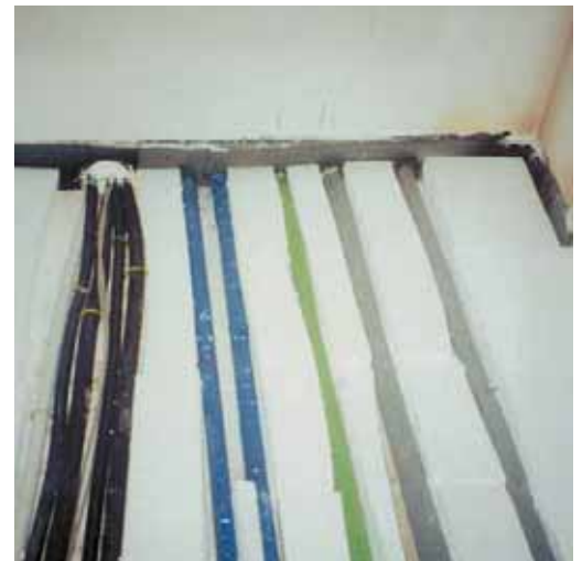
Warmwasserleitungen, ummantelt von der Estrich-Dämmung
