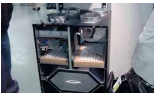
Abluftwärmerückgewinnung: Blick in ein Gerät
